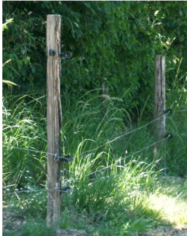
Photo 26. Installation électrique en clôture avec enherbement. Il faut éviter tout contact avec la végétation pour ne pas perdre en efficacité de charge.
